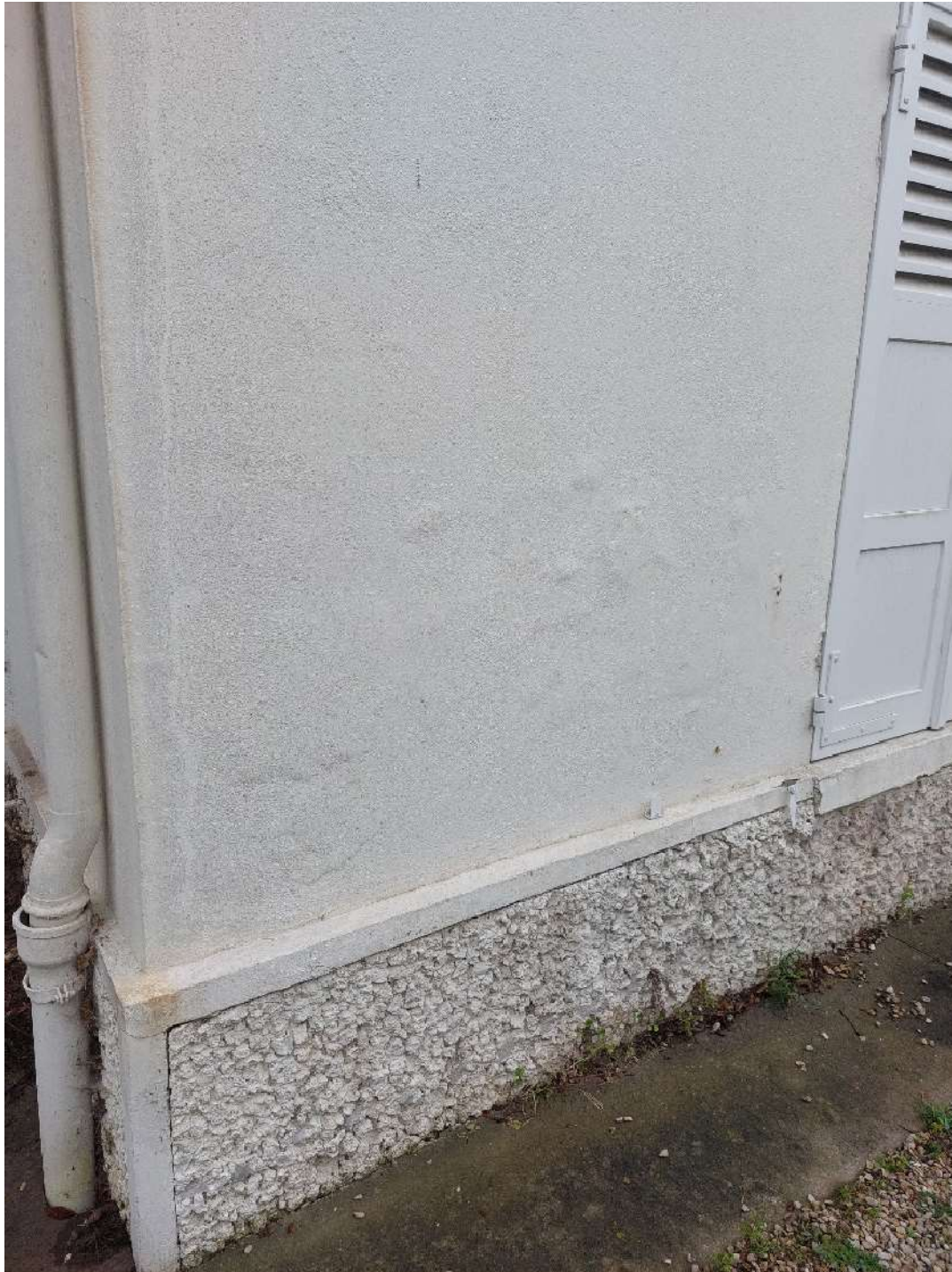
3 : Peinture boursouflée et soubassement en marcottage de meulière peint + rebouchages ciment visibles
