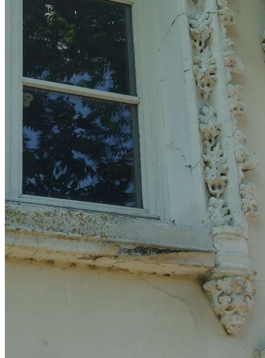
2 : Plomb peint sur appui dégradé sur appui R+1
