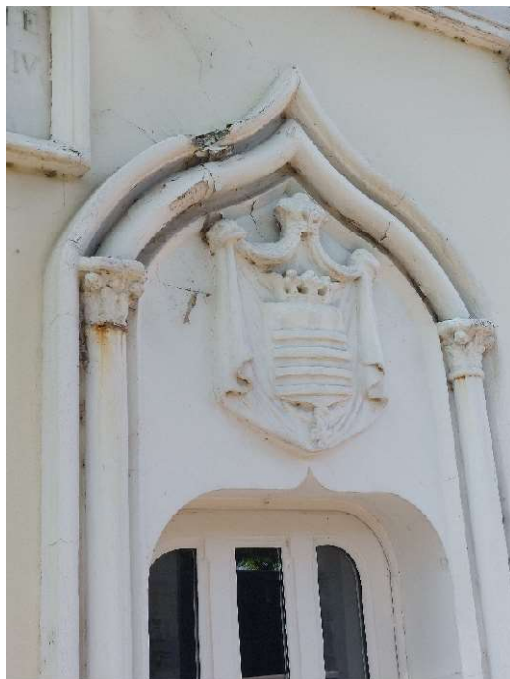
5 : Traces de rouille et dégradations du plâtre
